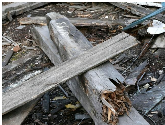
Разрушенные временем конструкции
