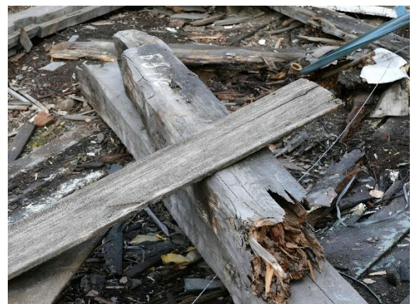
Разрушенные временем конструкции
